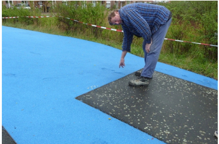
Ein Mitarbeiter des Betriebshofes begutachtet den Schaden.
