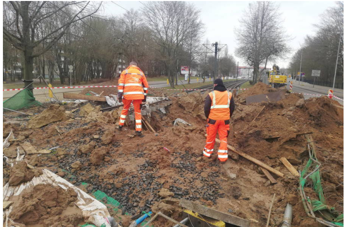
Die gesprengte Bombe unter der Erich-Panitz-Straße verursachte starke Schäden an der Stadtbahnlinie 1.
