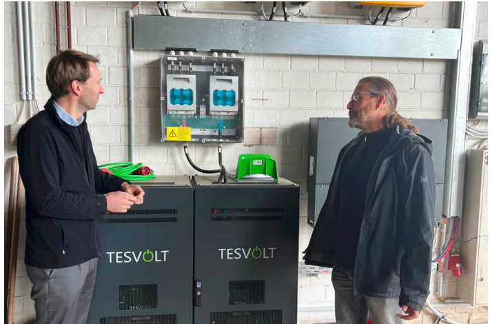
Bürgermeister Jan Dingeldey (links) sowie Ansgar Nieweg von der Abteilung Gebäudewirtschaft machen sich ein Bild von der neuen Anlage.
