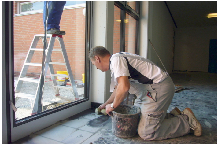
Manfred Körner verputzt die Fußbodenplatten vor der neuen Fensterfront im Forum der Grundschule Pestalozzistraße.
